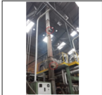
FOTOGRAFIA 7. DUCTO DE EXTRUSORA FARE
