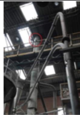
FOTOGRAFIA 9. DUCTO DE PALETIZADORA NO. 1 DEL AREA CONEXIONES
